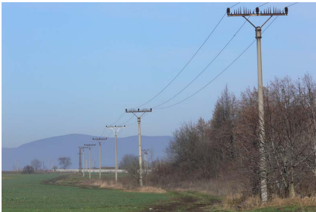
Obr.č.12 a 13: Elektrické vedenia s vodorovnými konzolami v obvode PPÚ nie sú všade zabezpečené umelohmotnými hrotmi proti dosadaniu vtáctva.
